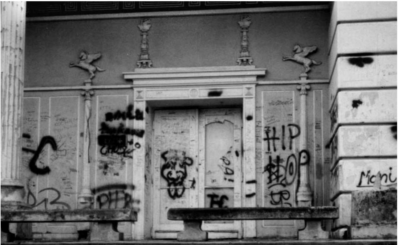
Na bladobłękitnych ścianach Domu Kultury wykonano liczne graffiti, spod których nie widać już rysunku płaskorzeźby. Fot. Magdalena Saganiak.
